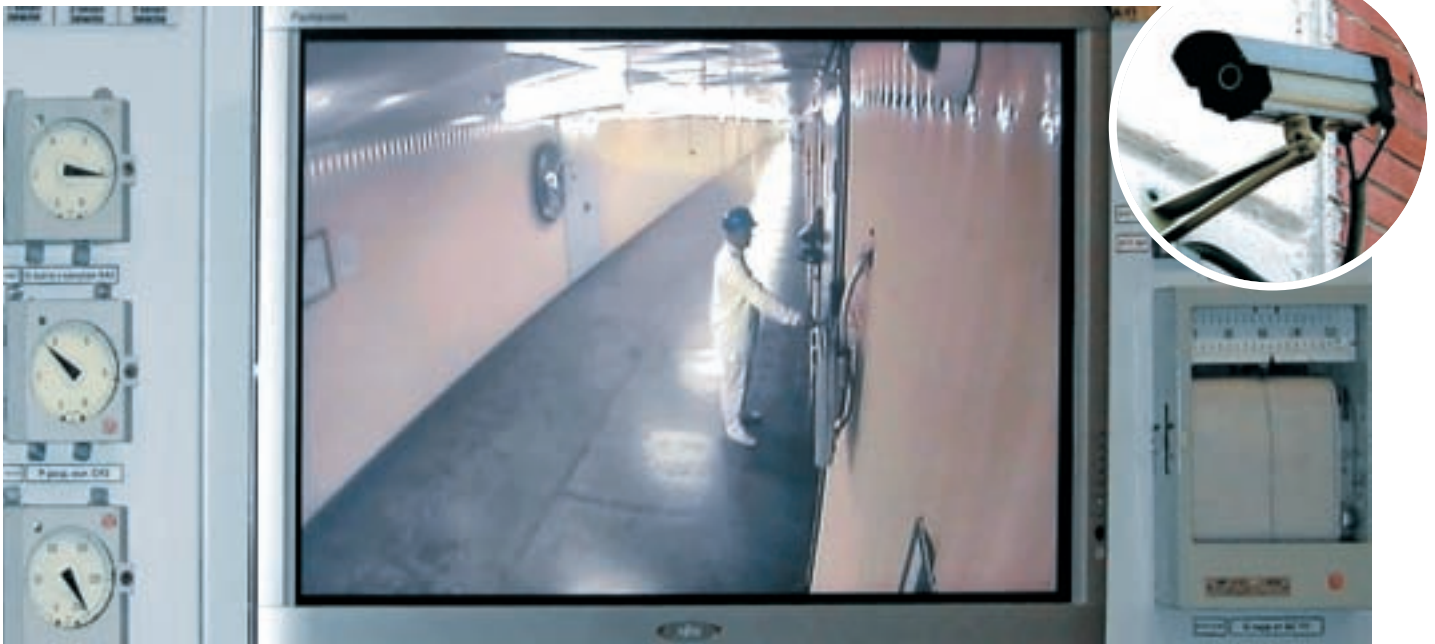
Камера охранного и обзорного телевидения. Внутренняя галерея АЭС
